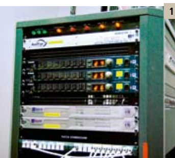
1: Il rack principale della rete EtherSound. 2: Il PM5D posto nella sala durante la messa a punto del sistema.
